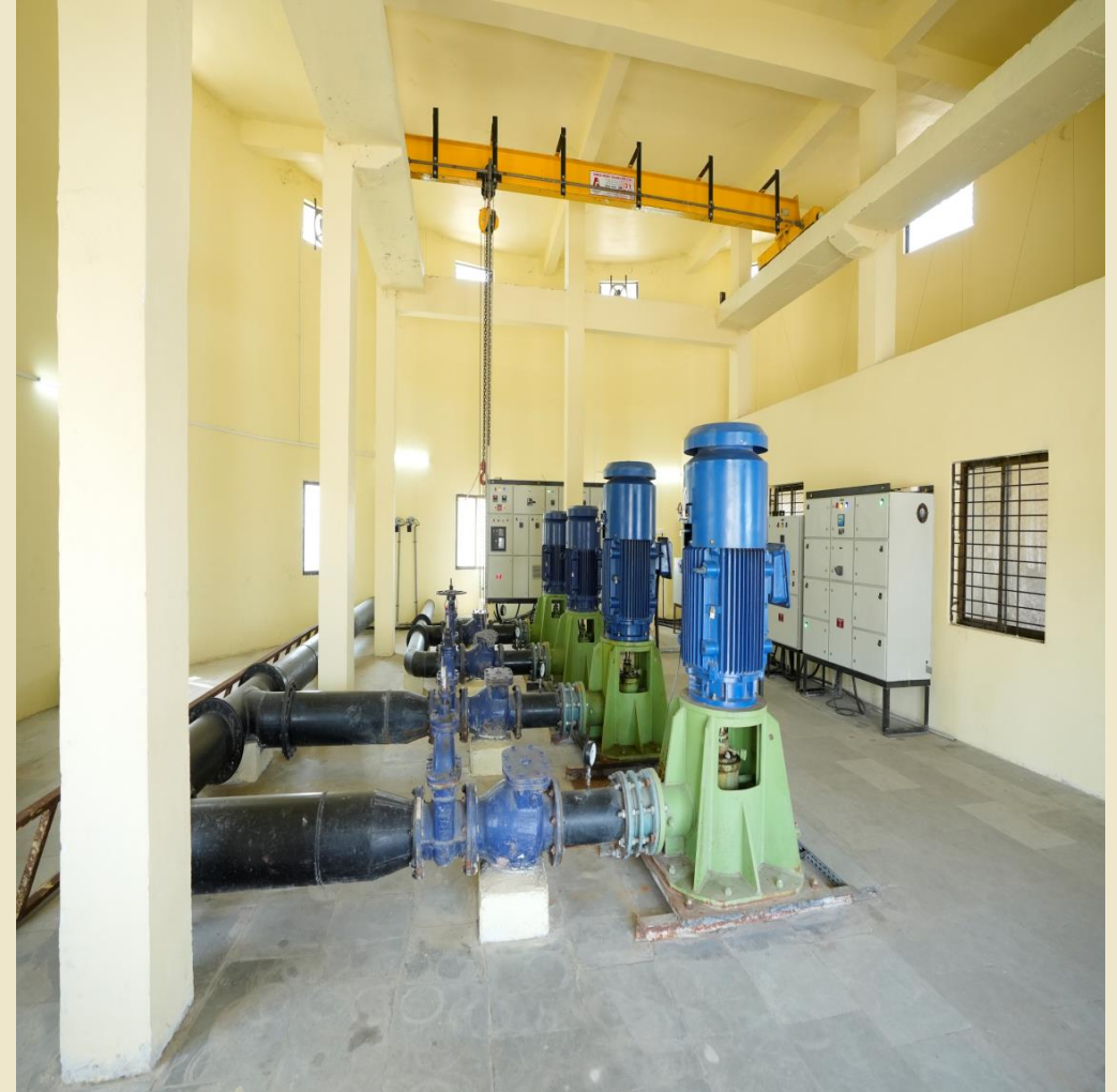
TTP Pumping Machinery
