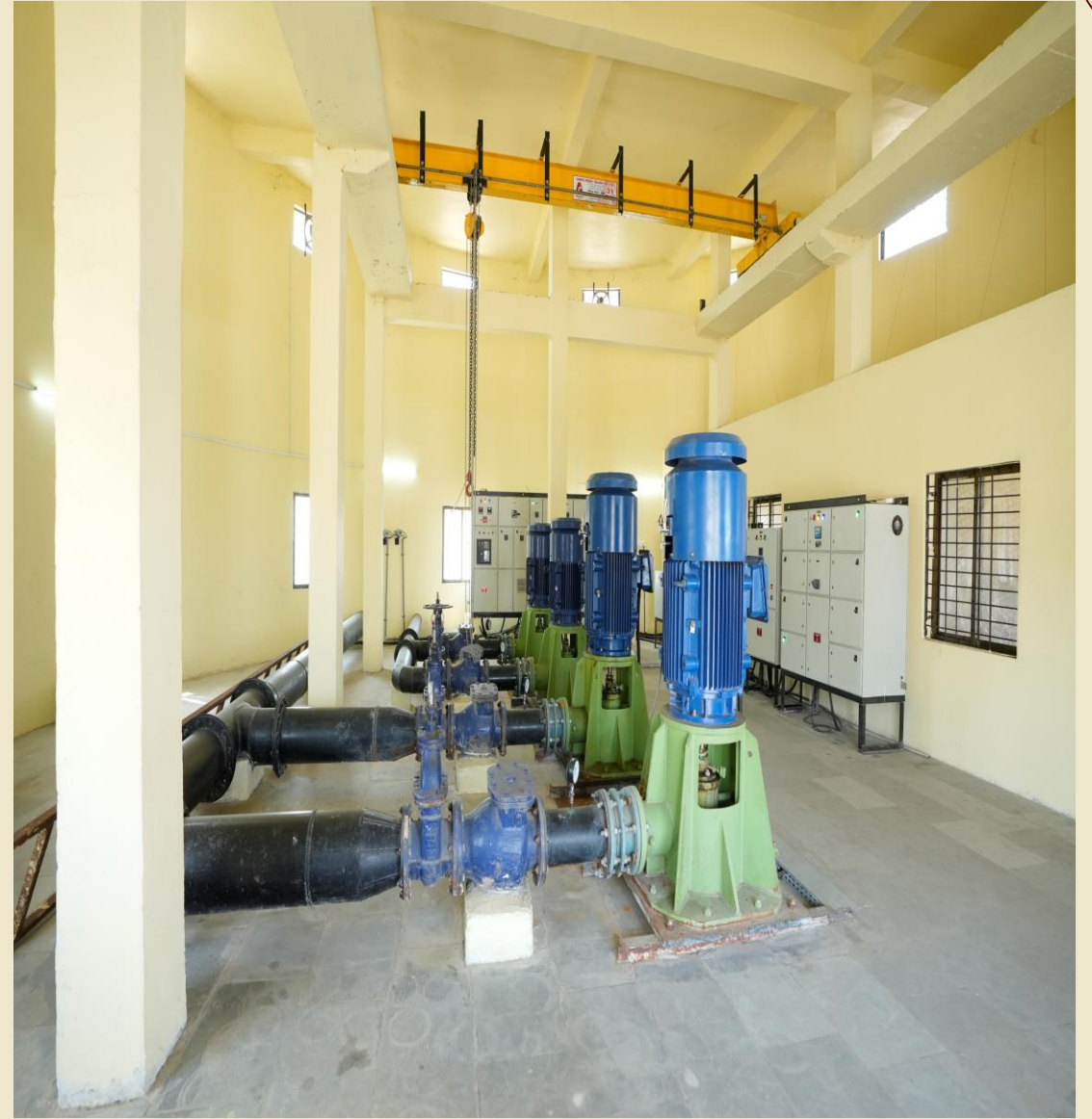
TTP Pumping Machinery
